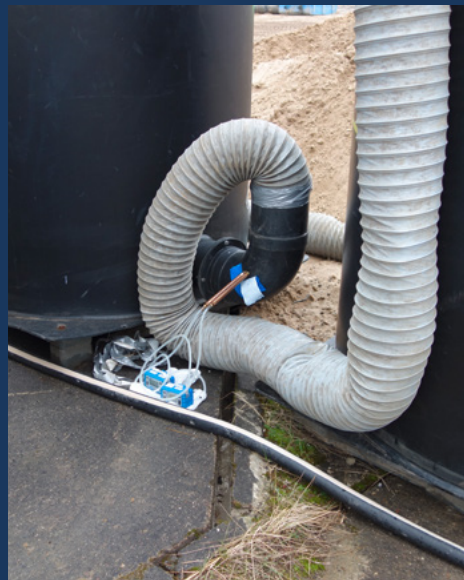
▲ Luftmessung der Prozessluft
