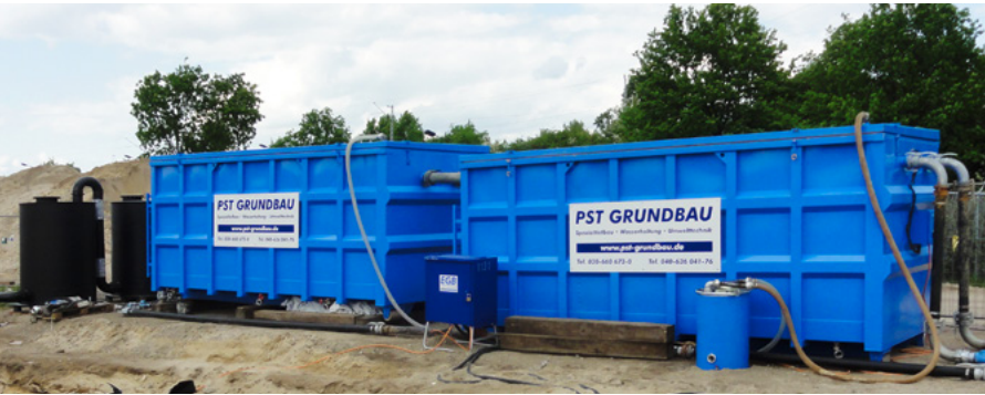
▲ Absetzstrecke und Druckerhöhungsstation sowie Abluftreinigung
