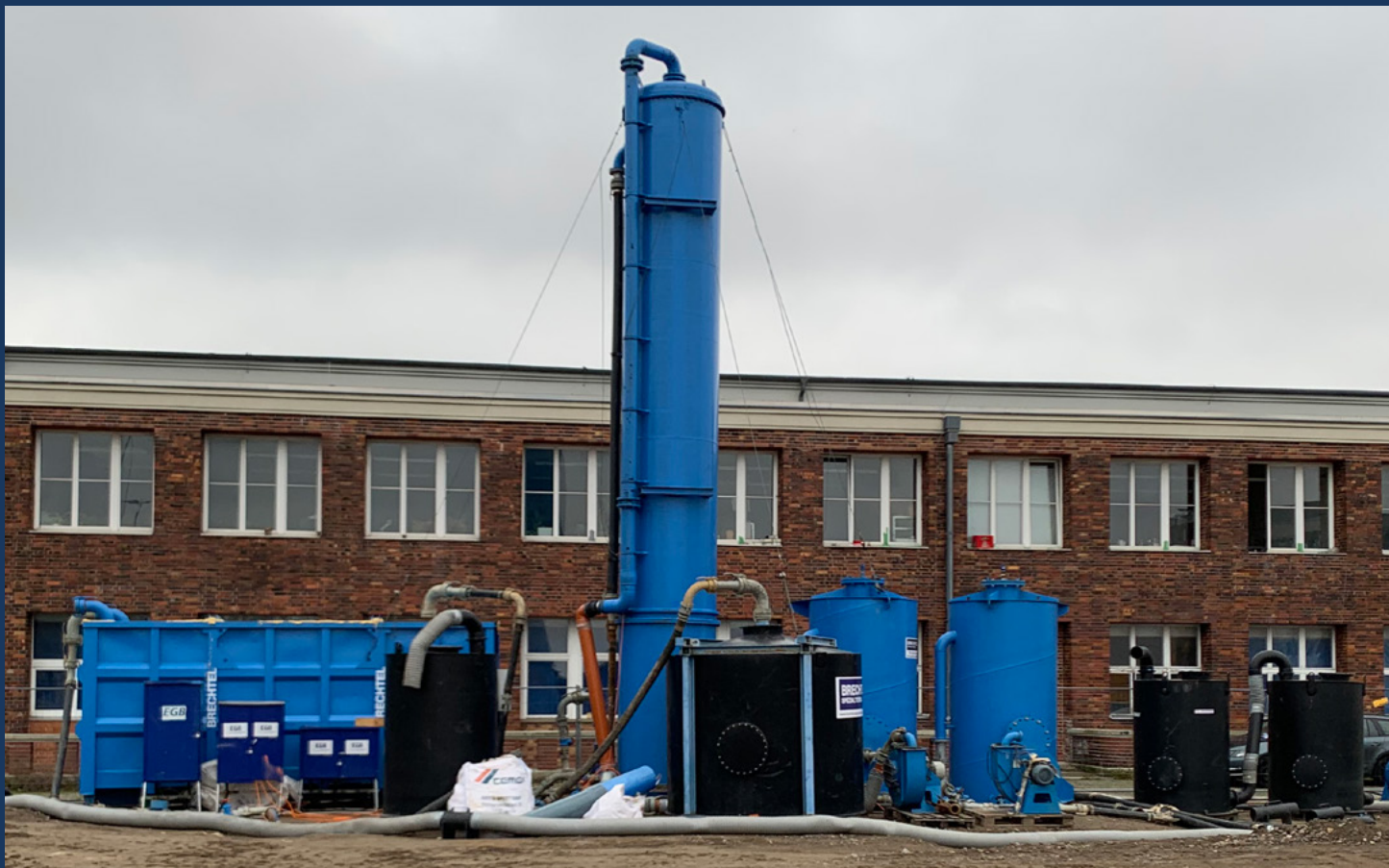
▲ Prozesswasserreinigung mit Absetzbecken, Stripturm und Aktivkohlefiltern
